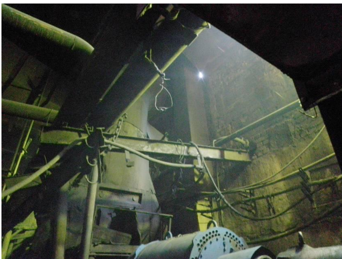
Разрушены металлоконструкции под опорой трубопровода, обвязан цепями, чтоб не слететь
