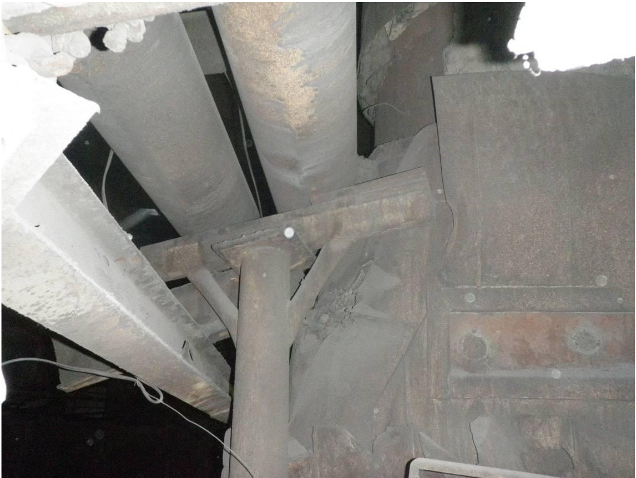
Металлоконструкция под опорой завалена
