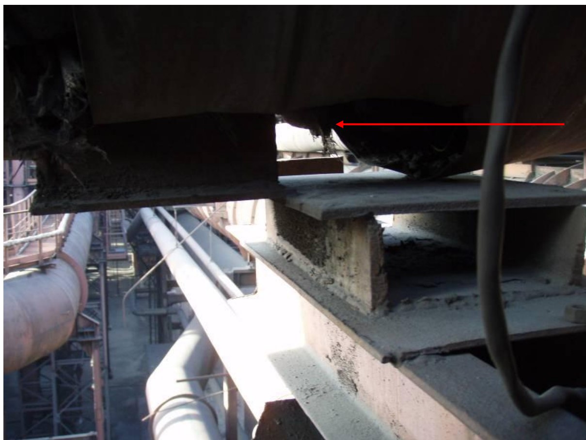
Скользящие опоры сошли с подошвы:
